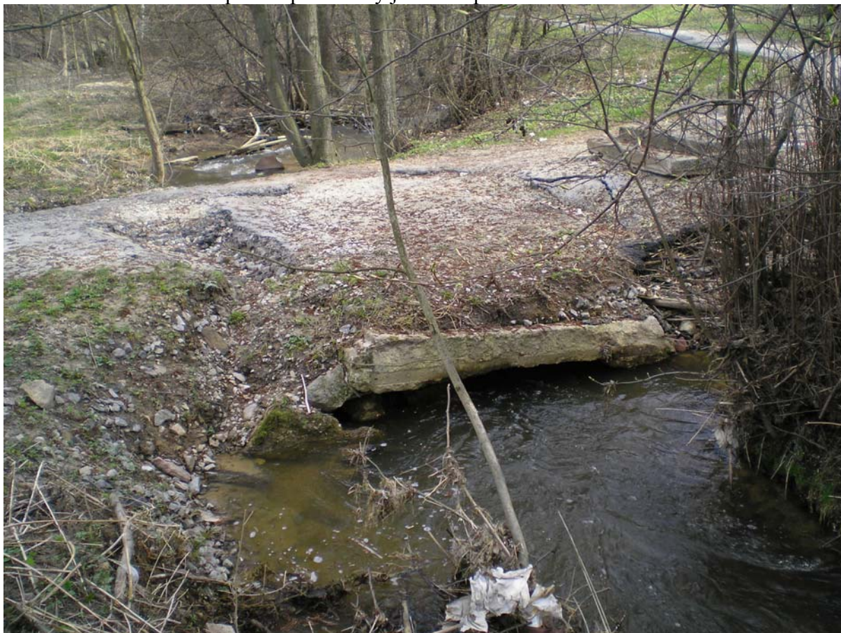
Mostek na Slavonickém potoce poškozený jednou z povodní
