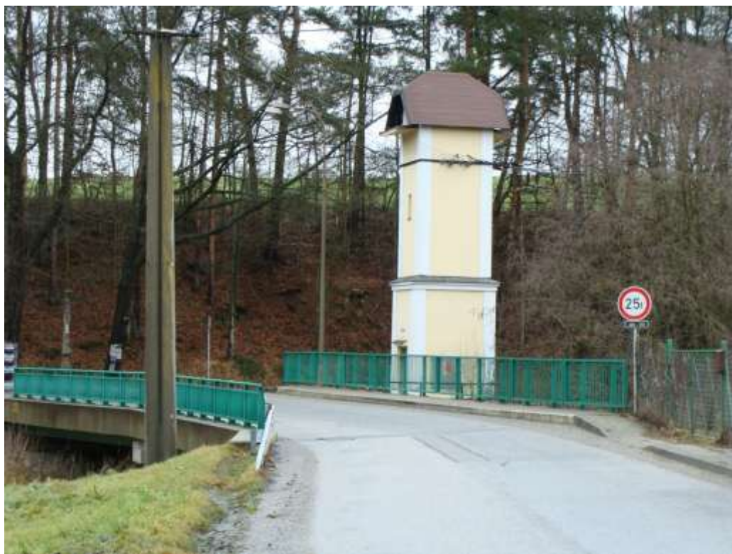
Most v Dolním Bolíkově – most navazuje na zatáčku a křižovatku – kolizní místo
